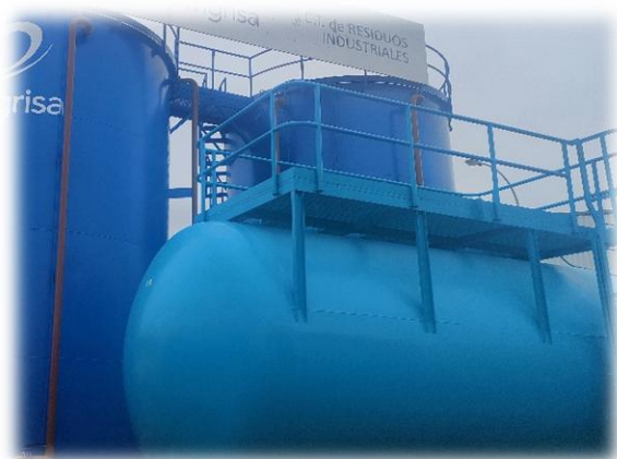
Tanques de almacenamiento temporal de aceite usado industrial, en Mérida.
